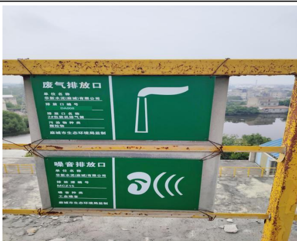
DA008 2#包装机排气筒标识牌
