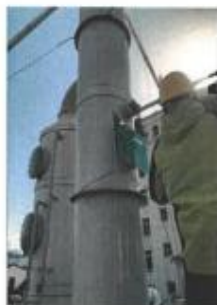
注液及表面清洁废气排气筒
